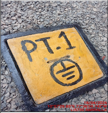
Pozo a tierra
