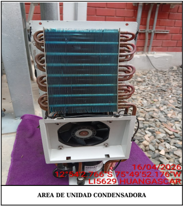
AREA DE UNIDAD CONDENSADORA
