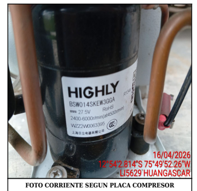
FOTO CORRIENTE SEGUN PLACA COMPRESOR
