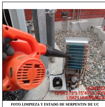
FOTO LIMPIEZA Y ESTADO DE SERPENTIN DE UC
