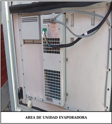
AREA DE UNIDAD EVAPORADORA
