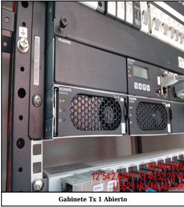
Gabinete Tx 1 Abierto
