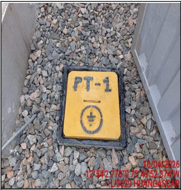
Pozo a tierra
