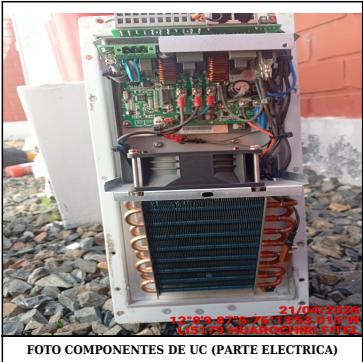
FOTO COMPONENTES DE UC (PARTE ELECTRICA)
