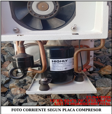
FOTO CORRIENTE SEGUN PLACA COMPRESOR
