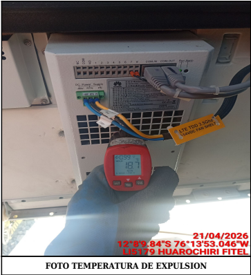
FOTO TEMPERATURA DE EXPULSION
