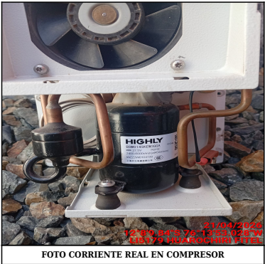
FOTO CORRIENTE REAL EN COMPRESOR
