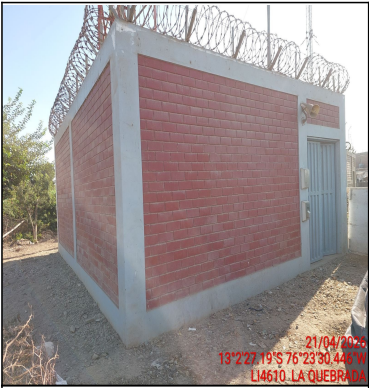
Pozo a tierra
