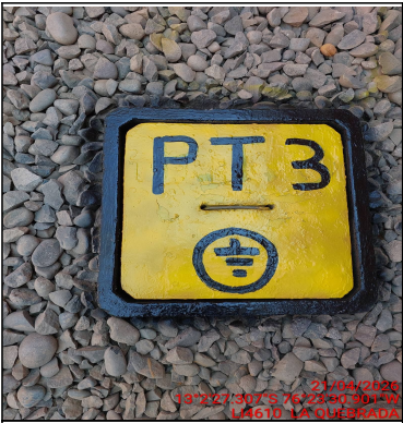
Pozo a tierra
