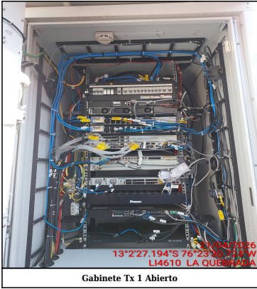
Gabinete Tx 1 Abierto
