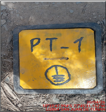
Pozo a tierra
