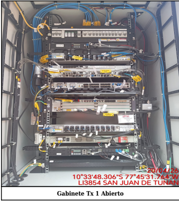
Gabinete Tx 1 Abierto
