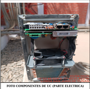
FOTO COMPONENTES DE UC (PARTE ELECTRICA)
