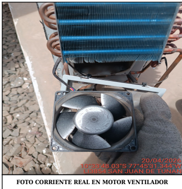
FOTO CORRIENTE REAL EN MOTOR VENTILADOR
