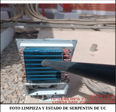
FOTO LIMPIEZA Y ESTADO DE SERPENTIN DE UC
