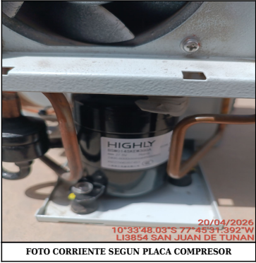
FOTO CORRIENTE SEGUN PLACA COMPRESOR
