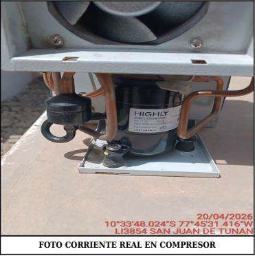
FOTO CORRIENTE REAL EN COMPRESOR
