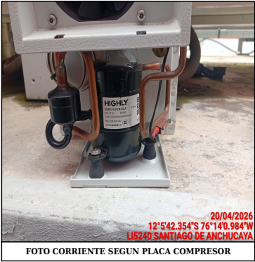
FOTO CORRIENTE SEGUN PLACA COMPRESOR
