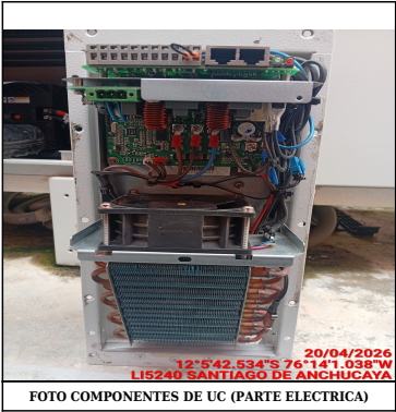
FOTO COMPONENTES DE UC (PARTE ELECTRICA)
