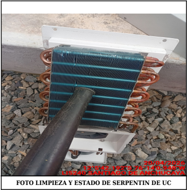
FOTO LIMPIEZA Y ESTADO DE SERPENTIN DE UC
