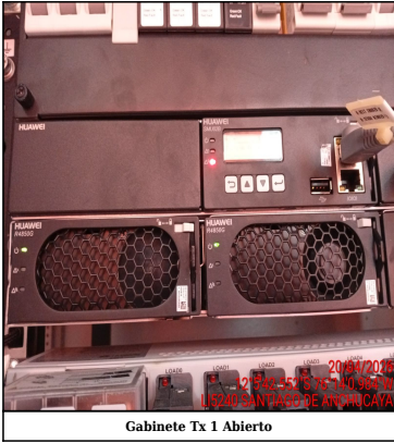
Gabinete Tx 1 Abierto
