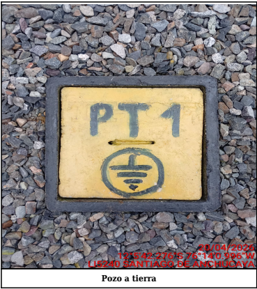
Pozo a tierra
