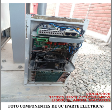
FOTO COMPONENTES DE UC (PARTE ELECTRICA)
