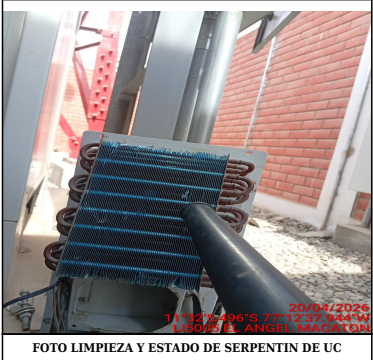
FOTO LIMPIEZA Y ESTADO DE SERPENTIN DE UC
