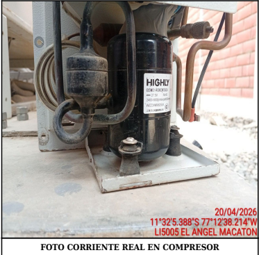
FOTO CORRIENTE REAL EN COMPRESOR
