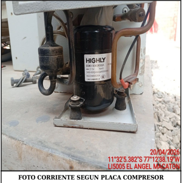
FOTO CORRIENTE SEGUN PLACA COMPRESOR
