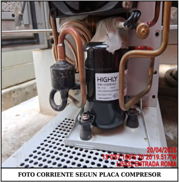
FOTO CORRIENTE SEGUN PLACA COMPRESOR
