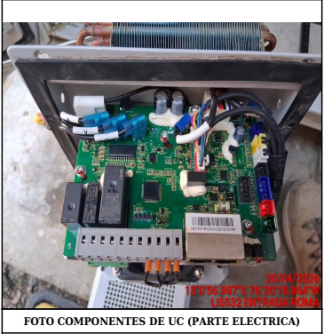
FOTO COMPONENTES DE UC (PARTE ELECTRICA)
