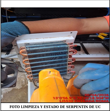
FOTO LIMPIEZA Y ESTADO DE SERPENTIN DE UC
