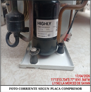
FOTO CORRIENTE SEGUN PLACA COMPRESOR
