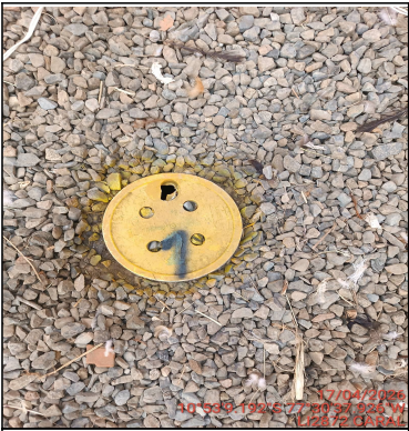
Pozo a tierra
