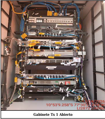
Gabinete Tx 1 Abierto
