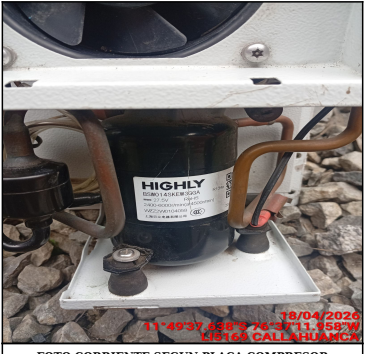
FOTO CORRIENTE SEGUN PLACA COMPRESOR
