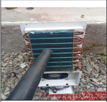
FOTO LIMPIEZA Y ESTADO DE SERPENTIN DE UC
