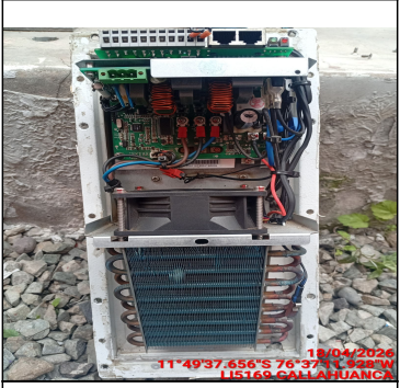
FOTO COMPONENTES DE UC (PARTE ELECTRICA)
