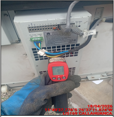
FOTO TEMPERATURA DE EXPULSION
