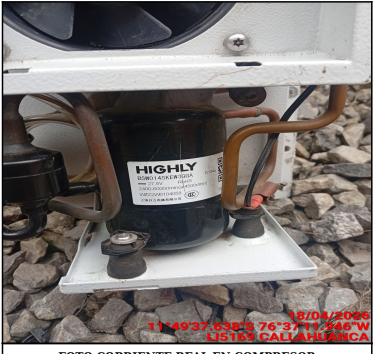
FOTO CORRIENTE REAL EN COMPRESOR
