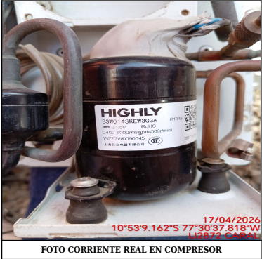
FOTO CORRIENTE REAL EN COMPRESOR
