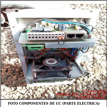
FOTO COMPONENTES DE UC (PARTE ELECTRICA)
