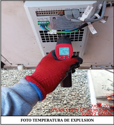
FOTO TEMPERATURA DE EXPULSION
