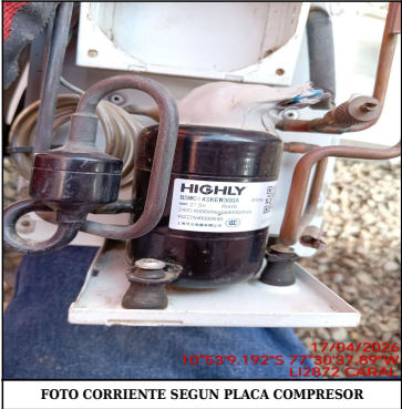
FOTO CORRIENTE SEGUN PLACA COMPRESOR
