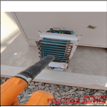
FOTO LIMPIEZA Y ESTADO DE SERPENTIN DE UC
