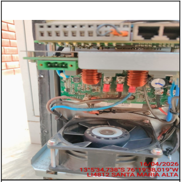
FOTO COMPONENTES DE UC (PARTE ELECTRICA)
