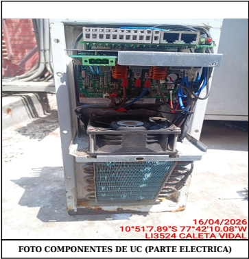
FOTO COMPONENTES DE UC (PARTE ELECTRICA)
