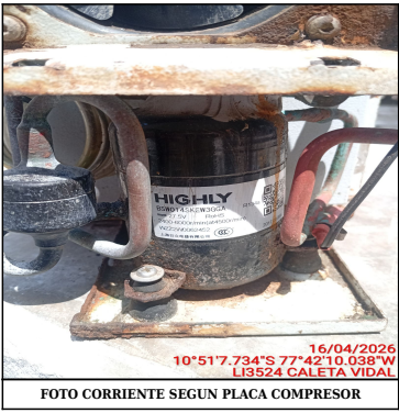
FOTO CORRIENTE SEGUN PLACA COMPRESOR
