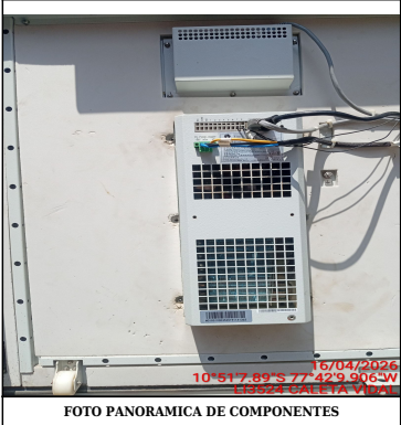
FOTO PANORAMICA DE COMPONENTES
