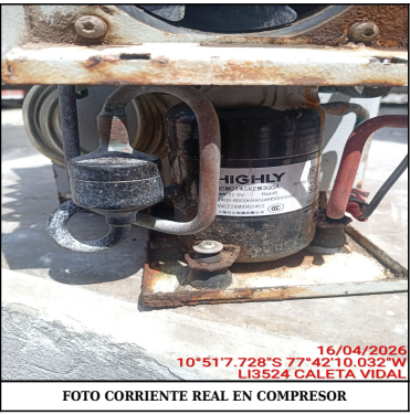
FOTO CORRIENTE REAL EN COMPRESOR
