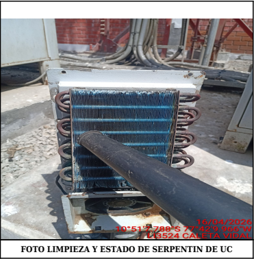
FOTO LIMPIEZA Y ESTADO DE SERPENTIN DE UC
