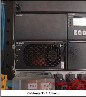
Gabinete Tx 1 Abierto
