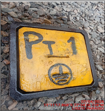
Pozo a tierra
