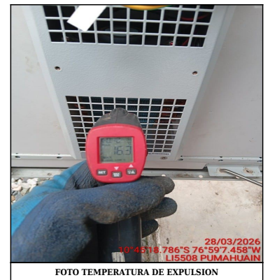
FOTO TEMPERATURA DE EXPULSION
