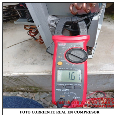
FOTO CORRIENTE REAL EN COMPRESOR
