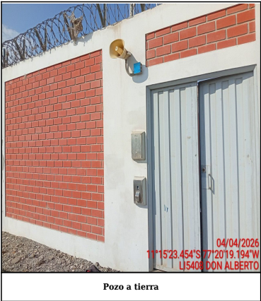
Pozo a tierra
