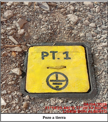
Pozo a tierra
