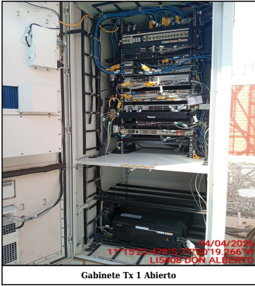
Gabinete Tx 1 Abierto
