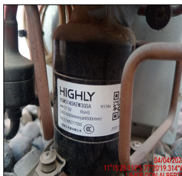
FOTO DE COMPRESOR
