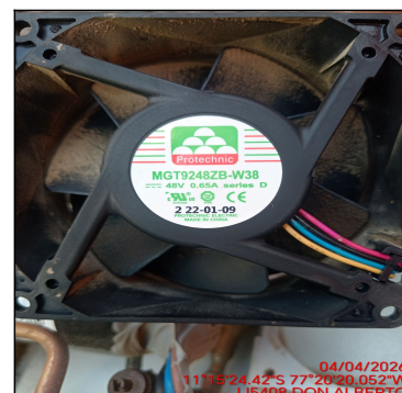
FOTO CORRIENTE SEGUN PLACA EN MOTOR VENTILADOR
