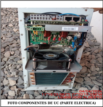
FOTO COMPONENTES DE UC (PARTE ELECTRICA)
