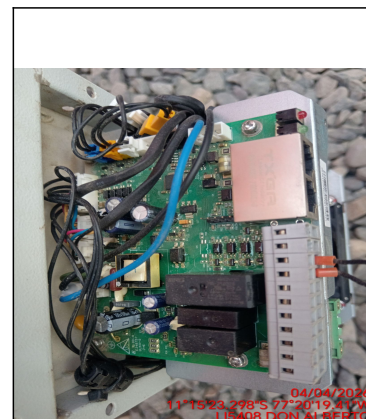
FOTO DE COMPONENTES DE UE (PARTE ELECTRICA)
