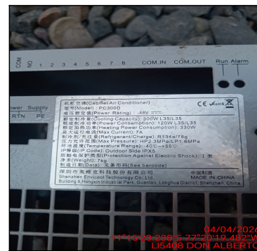
FOTO DE PLACA DE UNIDAD CONDENSADORA
