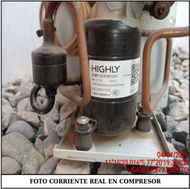
FOTO CORRIENTE REAL EN COMPRESOR
