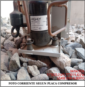
FOTO CORRIENTE SEGUN PLACA COMPRESOR
