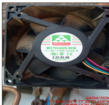
FOTO CORRIENTE REAL EN MOTOR VENTILADOR
