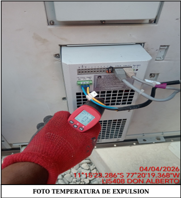
FOTO TEMPERATURA DE EXPULSION
