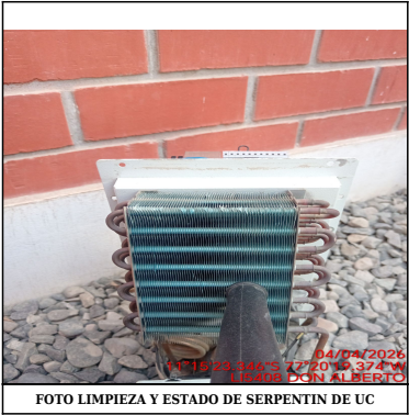
FOTO LIMPIEZA Y ESTADO DE SERPENTIN DE UC
