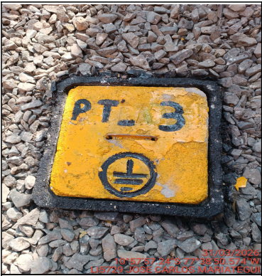
Pozo a tierra
