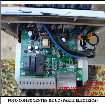
FOTO COMPONENTES DE UC (PARTE ELECTRICA)
