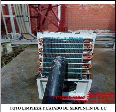
FOTO LIMPIEZA Y ESTADO DE SERPENTIN DE UC
