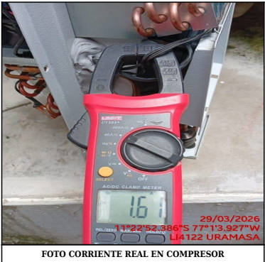
FOTO CORRIENTE REAL EN COMPRESOR
