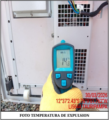
FOTO TEMPERATURA DE EXPULSION
