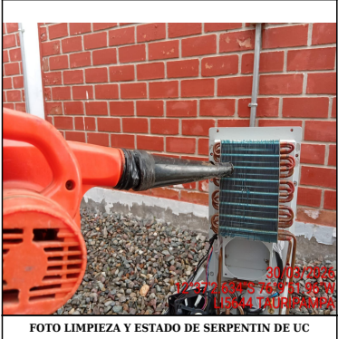
FOTO LIMPIEZA Y ESTADO DE SERPENTIN DE UC
