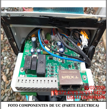
FOTO COMPONENTES DE UC (PARTE ELECTRICA)
