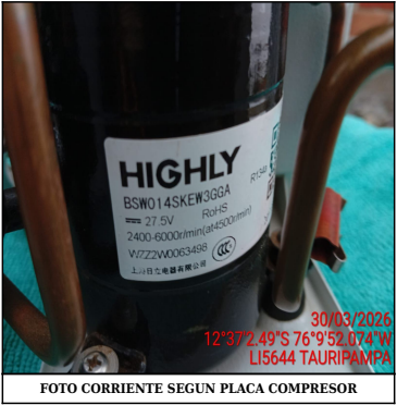
FOTO CORRIENTE SEGUN PLACA COMPRESOR
