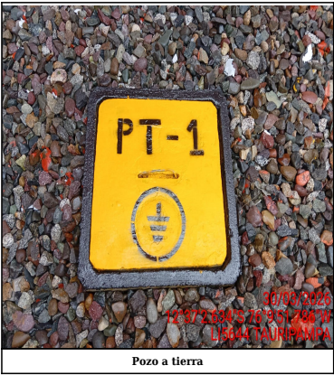
Pozo a tierra
