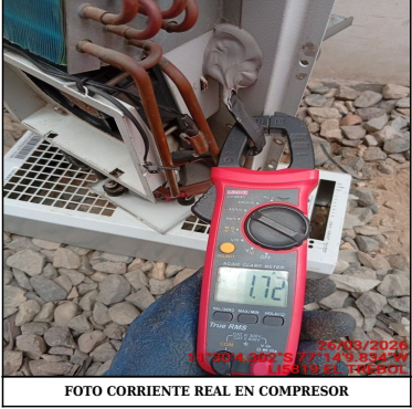
FOTO CORRIENTE REAL EN COMPRESOR
