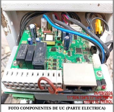
FOTO COMPONENTES DE UC (PARTE ELECTRICA)
