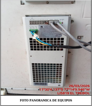
FOTO PANORAMICA DE EQUIPOS
