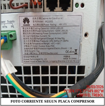
FOTO CORRIENTE SEGUN PLACA COMPRESOR
