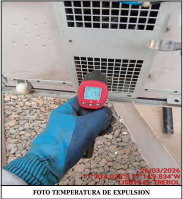
FOTO TEMPERATURA DE EXPULSION
