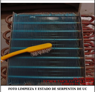
FOTO LIMPIEZA Y ESTADO DE SERPENTIN DE UC
