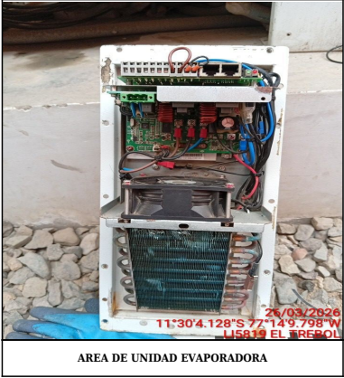
AREA DE UNIDAD EVAPORADORA
