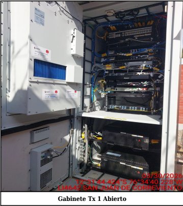
Gabinete Tx 1 Abierto
