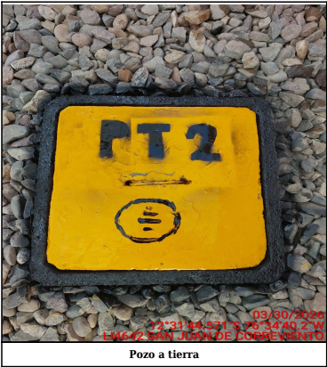
Pozo a tierra
