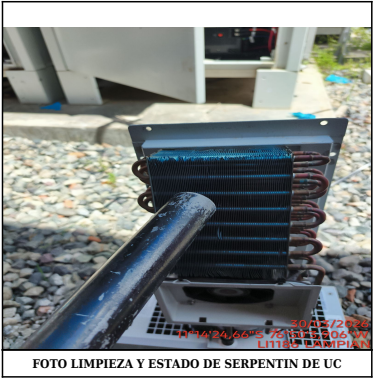
FOTO LIMPIEZA Y ESTADO DE SERPENTIN DE UC
