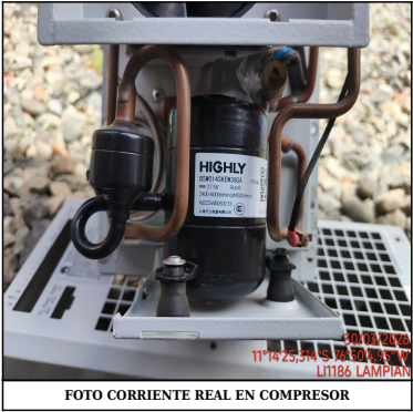
FOTO CORRIENTE REAL EN COMPRESOR
