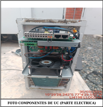
FOTO COMPONENTES DE UC (PARTE ELECTRICA)
