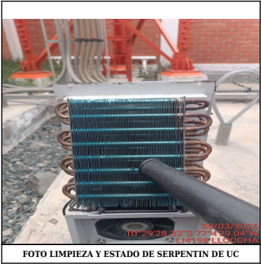
FOTO LIMPIEZA Y ESTADO DE SERPENTIN DE UC
