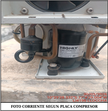
FOTO CORRIENTE SEGUN PLACA COMPRESOR
