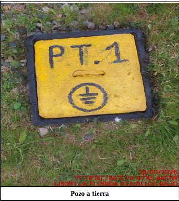
Pozo a tierra
