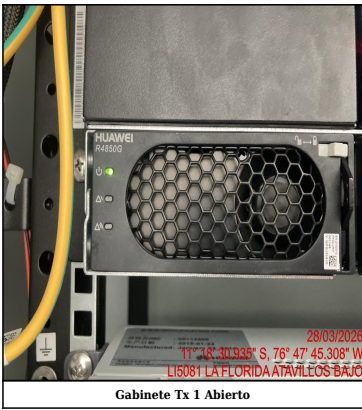
Gabinete Tx 1 Abierto
