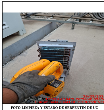
FOTO LIMPIEZA Y ESTADO DE SERPENTIN DE UC
