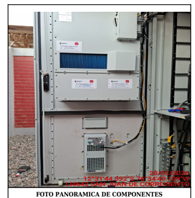
FOTO PANORAMICA DE COMPONENTES
