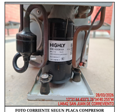
FOTO CORRIENTE SEGUN PLACA COMPRESOR
