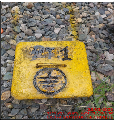
Pozo a tierra
