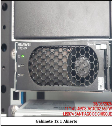
Gabinete Tx 1 Abierto
