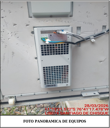
FOTO PANORAMICA DE EQUIPOS
