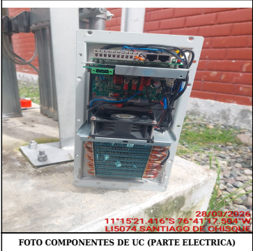
FOTO COMPONENTES DE UC (PARTE ELECTRICA)
