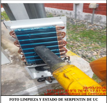
FOTO LIMPIEZA Y ESTADO DE SERPENTIN DE UC
