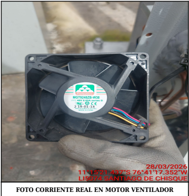
FOTO CORRIENTE REAL EN MOTOR VENTILADOR
