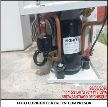
FOTO CORRIENTE REAL EN COMPRESOR
