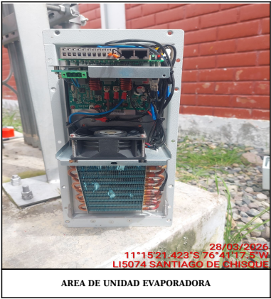
AREA DE UNIDAD EVAPORADORA
