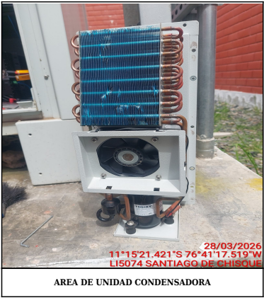
AREA DE UNIDAD CONDENSADORA
