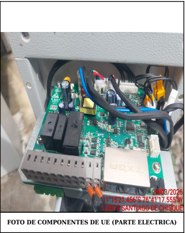
FOTO DE COMPONENTES DE UE (PARTE ELECTRICA)
