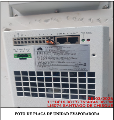
FOTO DE PLACA DE UNIDAD EVAPORADORA
