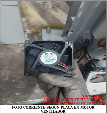
FOTO CORRIENTE SEGUN PLACA EN MOTOR VENTILADOR
