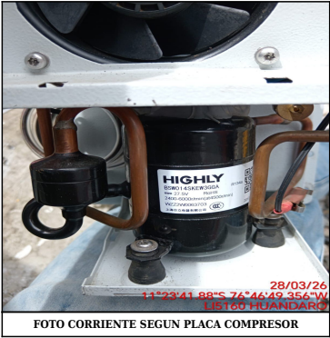
FOTO CORRIENTE SEGUN PLACA COMPRESOR
