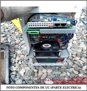
FOTO COMPONENTES DE UC (PARTE ELECTRICA)
