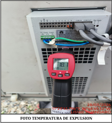
FOTO TEMPERATURA DE EXPULSION
