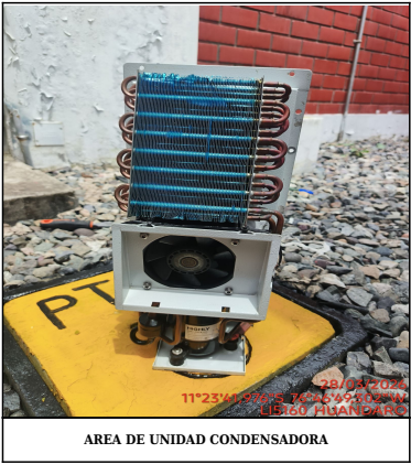
AREA DE UNIDAD CONDENSADORA
