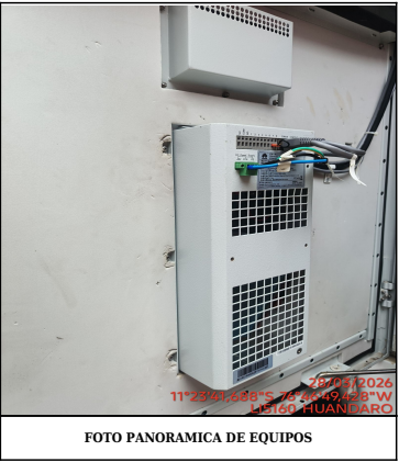
FOTO PANORAMICA DE EQUIPOS
