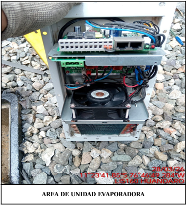
AREA DE UNIDAD EVAPORADORA
