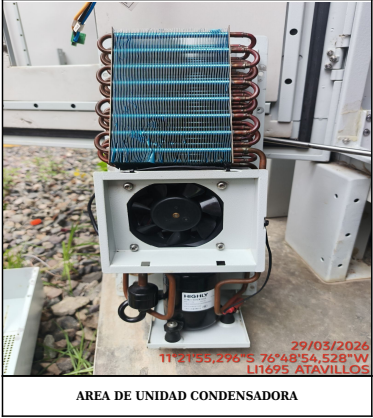
AREA DE UNIDAD CONDENSADORA
