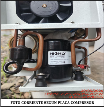
FOTO CORRIENTE SEGUN PLACA COMPRESOR
