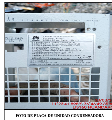
FOTO DE PLACA DE UNIDAD CONDENSADORA
