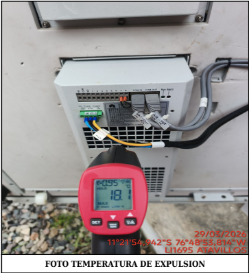
FOTO TEMPERATURA DE EXPULSION
