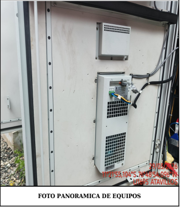
FOTO PANORAMICA DE EQUIPOS
