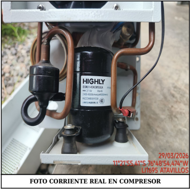
FOTO CORRIENTE REAL EN COMPRESOR
