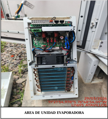
AREA DE UNIDAD EVAPORADORA
