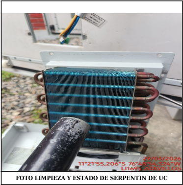
FOTO LIMPIEZA Y ESTADO DE SERPENTIN DE UC
