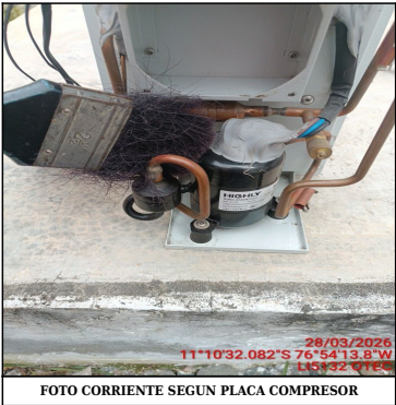
FOTO CORRIENTE SEGUN PLACA COMPRESOR
