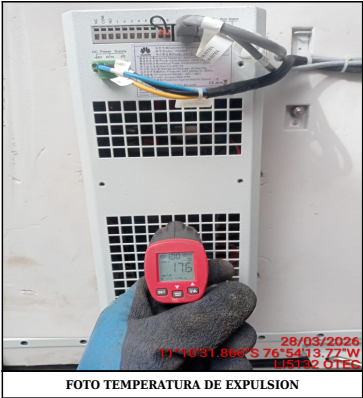
FOTO TEMPERATURA DE EXPULSION
