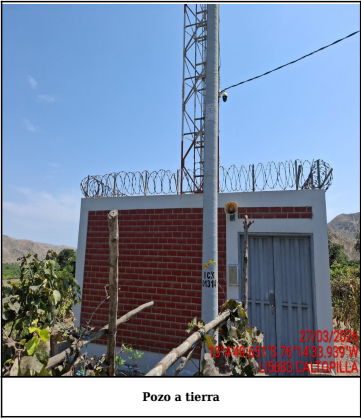
Pozo a tierra
