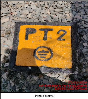
Pozo a tierra
