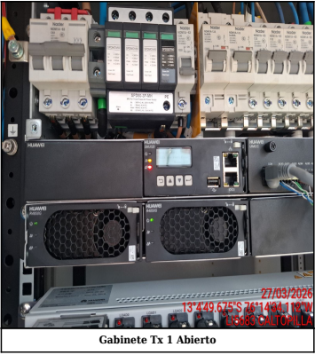
Gabinete Tx 1 Abierto
