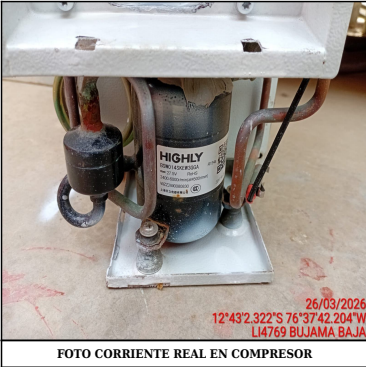
FOTO CORRIENTE REAL EN COMPRESOR
