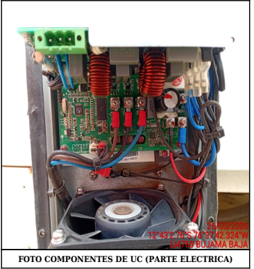
FOTO COMPONENTES DE UC (PARTE ELECTRICA)
