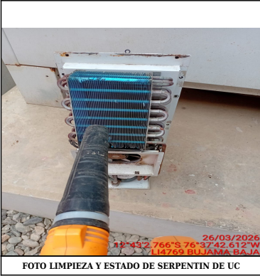
FOTO LIMPIEZA Y ESTADO DE SERPENTIN DE UC
