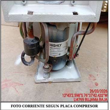
FOTO CORRIENTE SEGUN PLACA COMPRESOR
