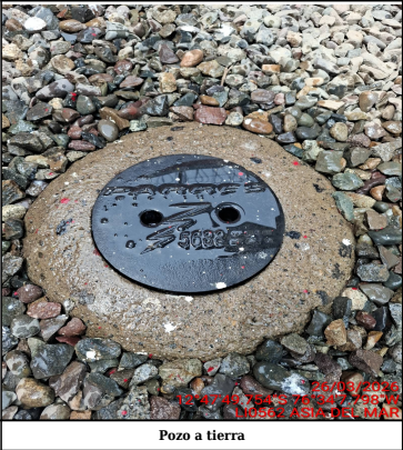
Pozo a tierra
