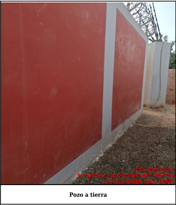
Pozo a tierra
