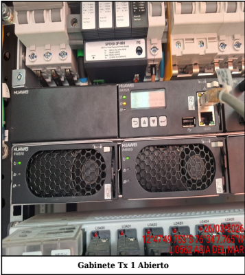
Gabinete Tx 1 Abierto
