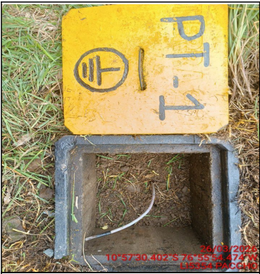
Pozo a tierra
