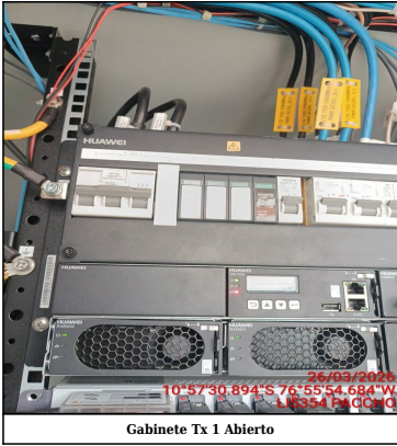
Gabinete Tx 1 Abierto
