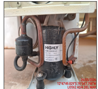
FOTO CORRIENTE SEGUN PLACA COMPRESOR
