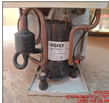
FOTO CORRIENTE REAL EN COMPRESOR
