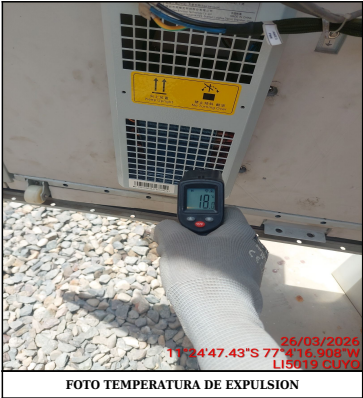
FOTO TEMPERATURA DE EXPULSION
