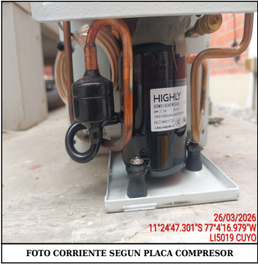
FOTO CORRIENTE SEGUN PLACA COMPRESOR
