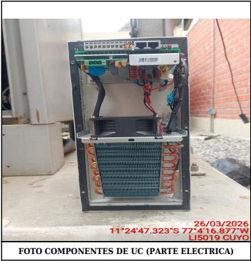
FOTO COMPONENTES DE UC (PARTE ELECTRICA)
