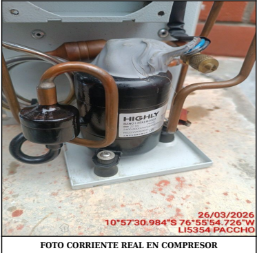
FOTO CORRIENTE REAL EN COMPRESOR
