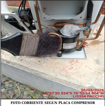
FOTO CORRIENTE SEGUN PLACA COMPRESOR
