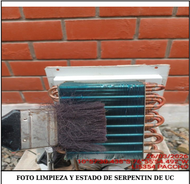
FOTO LIMPIEZA Y ESTADO DE SERPENTIN DE UC
