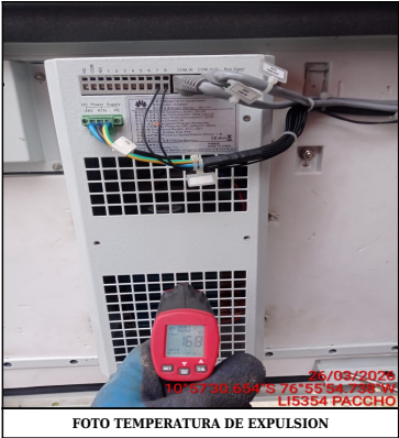
FOTO TEMPERATURA DE EXPULSION
