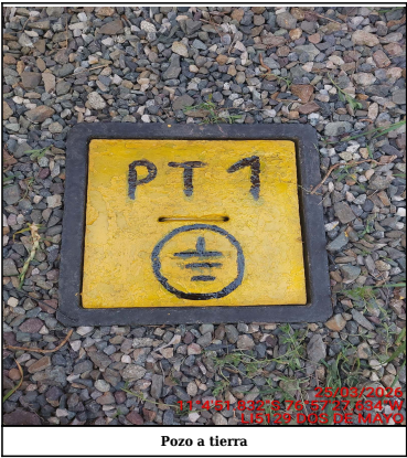
Pozo a tierra
