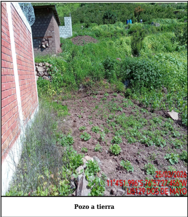
Pozo a tierra
