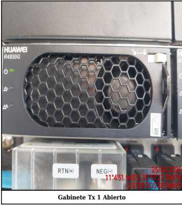
Gabinete Tx 1 Abierto
