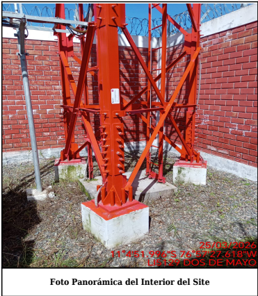
Foto Panorámica del Interior del Site
