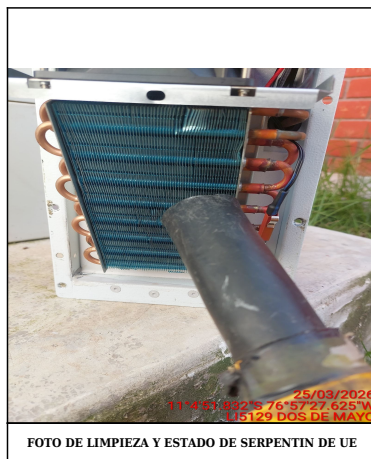
FOTO DE LIMPIEZA Y ESTADO DE SERPENTIN DE U
