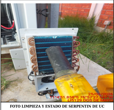
FOTO LIMPIEZA Y ESTADO DE SERPENTIN DE UC
