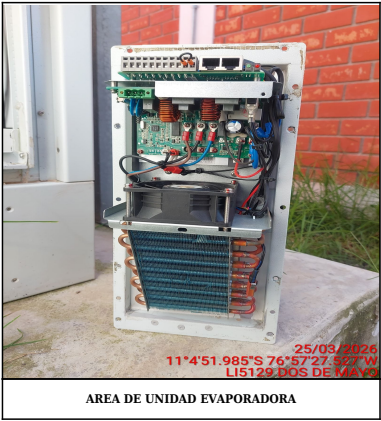
AREA DE UNIDAD EVAPORADORA
