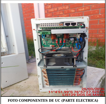
FOTO COMPONENTES DE UC (PARTE ELECTRICA)
