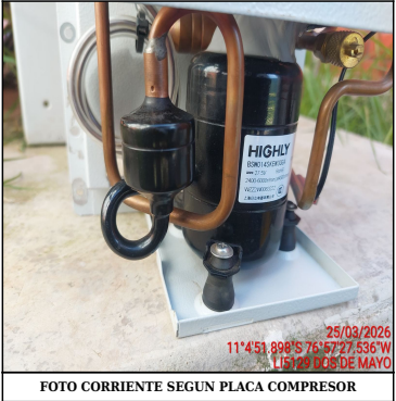
FOTO CORRIENTE SEGUN PLACA COMPRESOR
