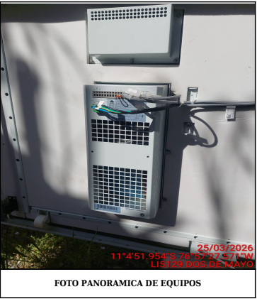
FOTO PANORAMICA DE EQUIPOS
