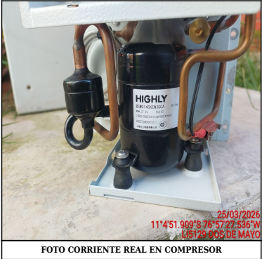
FOTO CORRIENTE REAL EN COMPRESOR
