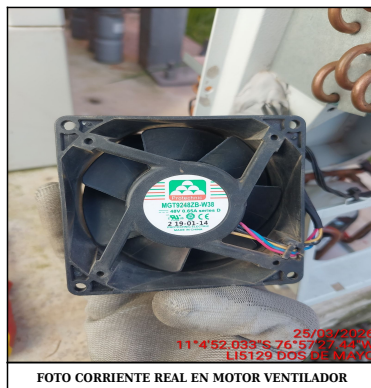
FOTO CORRIENTE REAL EN MOTOR VENTILADOR
