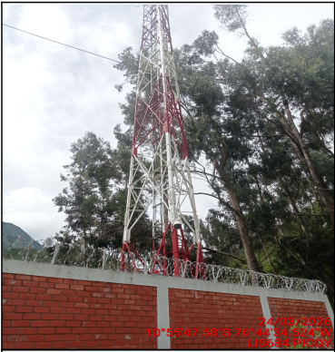
Pozo a tierra
