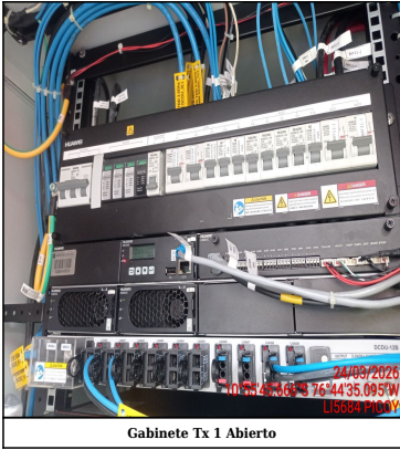
Gabinete Tx 1 Abierto
