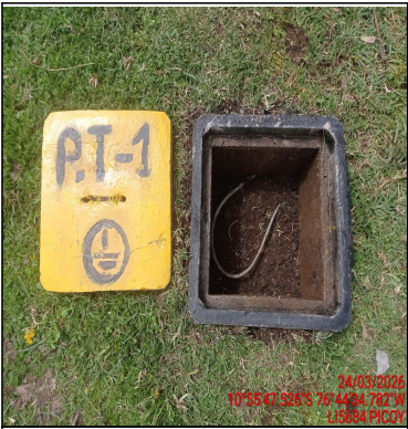
Pozo a tierra
