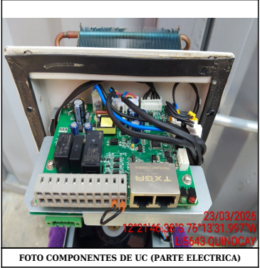
FOTO COMPONENTES DE UC (PARTE ELECTRICA)
