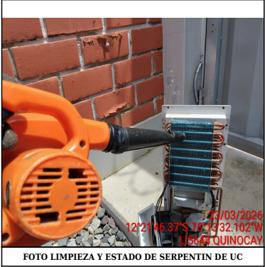
FOTO LIMPIEZA Y ESTADO DE SERPENTIN DE UC
