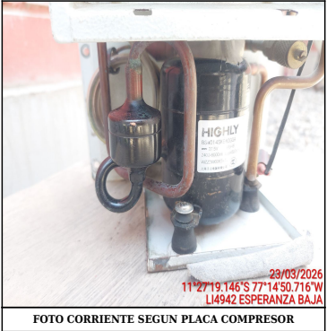
FOTO CORRIENTE SEGUN PLACA COMPRESOR
