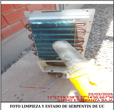
FOTO LIMPIEZA Y ESTADO DE SERPENTIN DE UC
