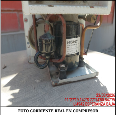
FOTO CORRIENTE REAL EN COMPRESOR
