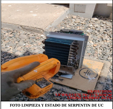
FOTO LIMPIEZA Y ESTADO DE SERPENTIN DE UC
