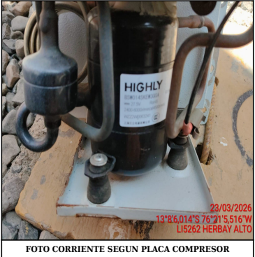
FOTO CORRIENTE SEGUN PLACA COMPRESOR
