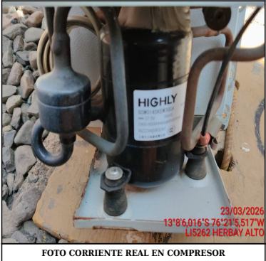
FOTO CORRIENTE REAL EN COMPRESOR
