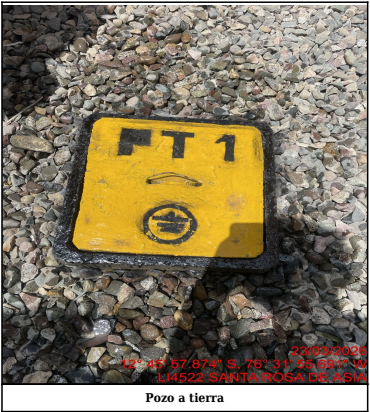
Pozo a tierra
