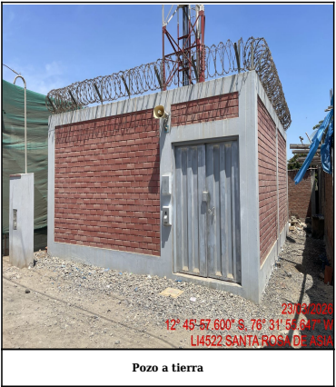
Pozo a tierra
