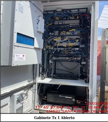
Gabinete Tx 1 Abierto
